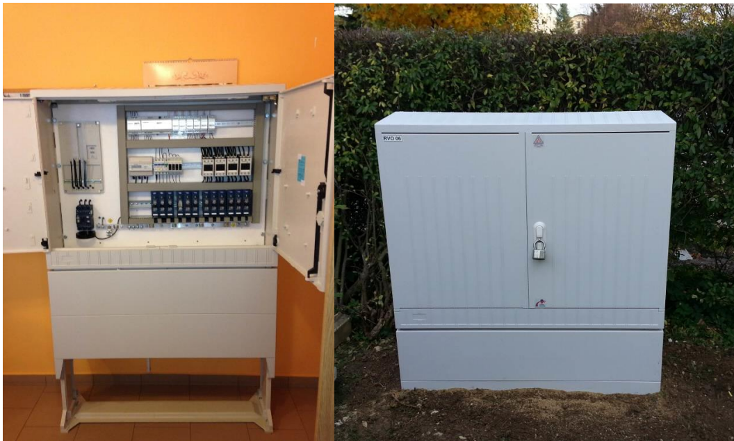
Obrázek č. 6 – Rozvaděč VO s řídícími rozvodnicemi
